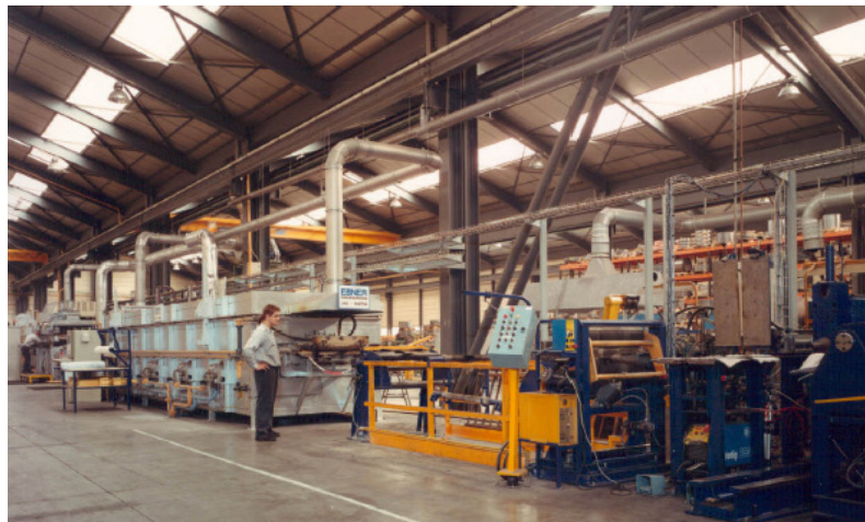
Figura 3: Foto da seção de entrada e de forno de austenitização [3].
